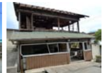
写真15 残留傾斜と水平移動
