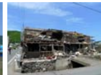
写真14 大破した木造建物
