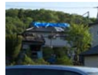
写真10 瓦屋根の被害
