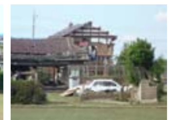
写真18 小屋組の被害
