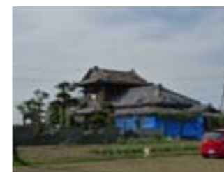
写真16 屋根瓦の被害
