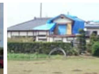
写真17 屋根瓦・外装材の被害
