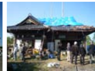
写真8 伝統木造建物の被害
