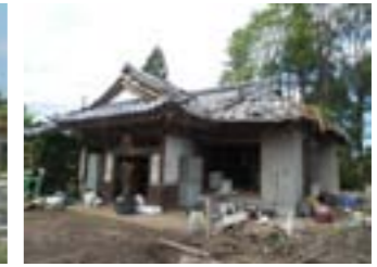
写真6 伝統木造建物の被害
