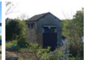
写真9 在来木造建物の被害
