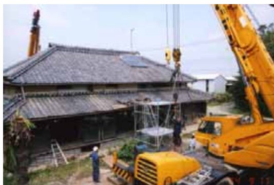
図3 明治31年築の伝統住宅 クレーン2台による水平力繰返し載荷実験
